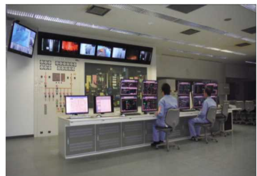
写真 1>清掃工場の中央監視システム
