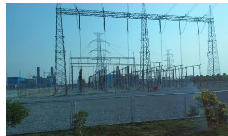
独自の発電所（ロジャナパワー社）
