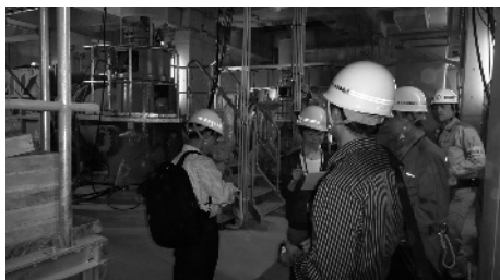
藤田ポンプ場
