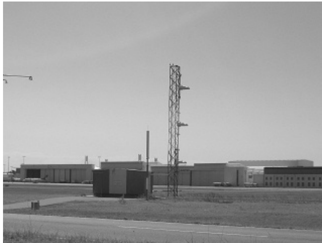
シドニー国際空港の滑走路 25 に設置されている ILS アンテナの一部 (109.7MHz の電波で運用されている)
