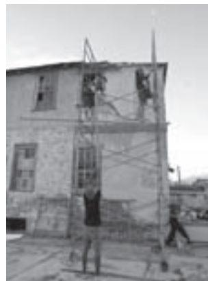
治安を考慮し、専門技術を持った少数のボランティアで改修した
