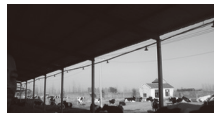
牛舎によっては細霧装置が設置されていた
