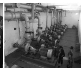
設備保守点検実習
