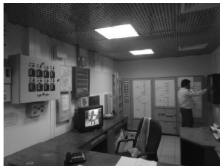
病院の防災センター (消防用設備の点検は定期的実施しているとのことであったが、消防署へ報告する義務もなく、それを確認する手段がない。)
