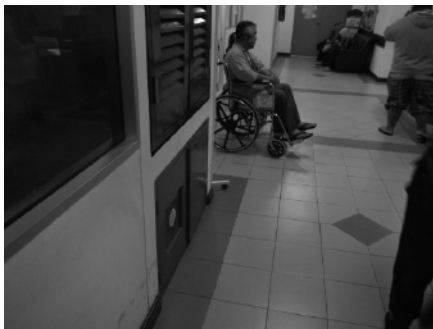
病院の屋内消火栓 (場所が分かりづらいため、万が一の時にすぐ使えるか不安である。)
